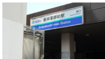
写真上:1960年代頃の新井薬師前駅 写真提供:西武鉄道 写真下:現在の新井薬師前駅(工事中)
